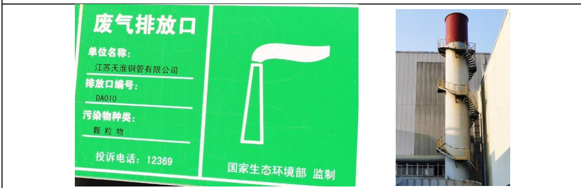
DA010 塑烧板除尘废气排放口及治理措施
