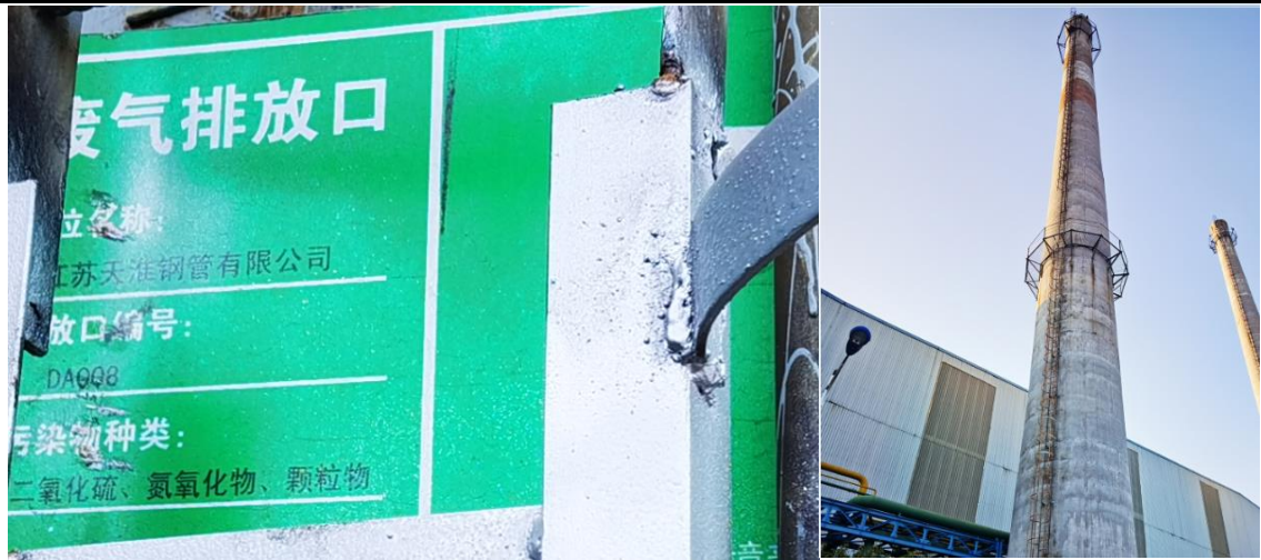
DA008 淬火炉废气排放口
